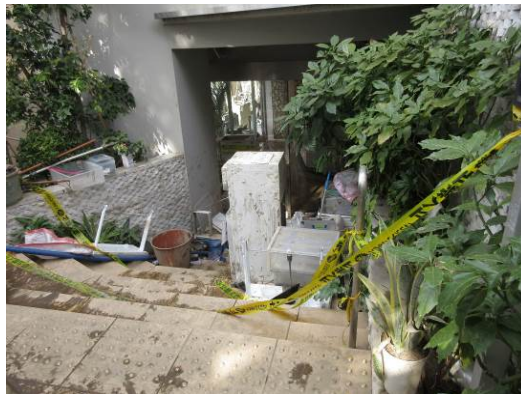
写真2 住宅（地下店舗）の浸水被害（当社撮影）
