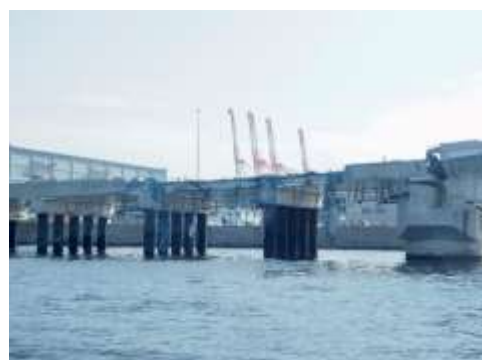
南本牧はま道路の崩壊
